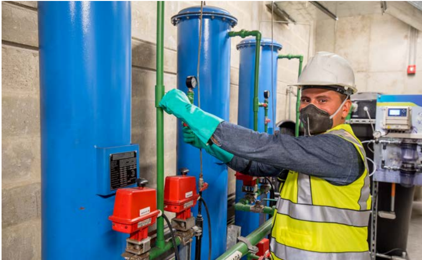
Planta de tratamiento de aguas lluvias, aeropuerto El Dorado.
