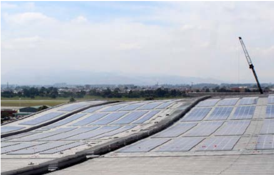
Paneles solares Aeropuerto El Dorado.
