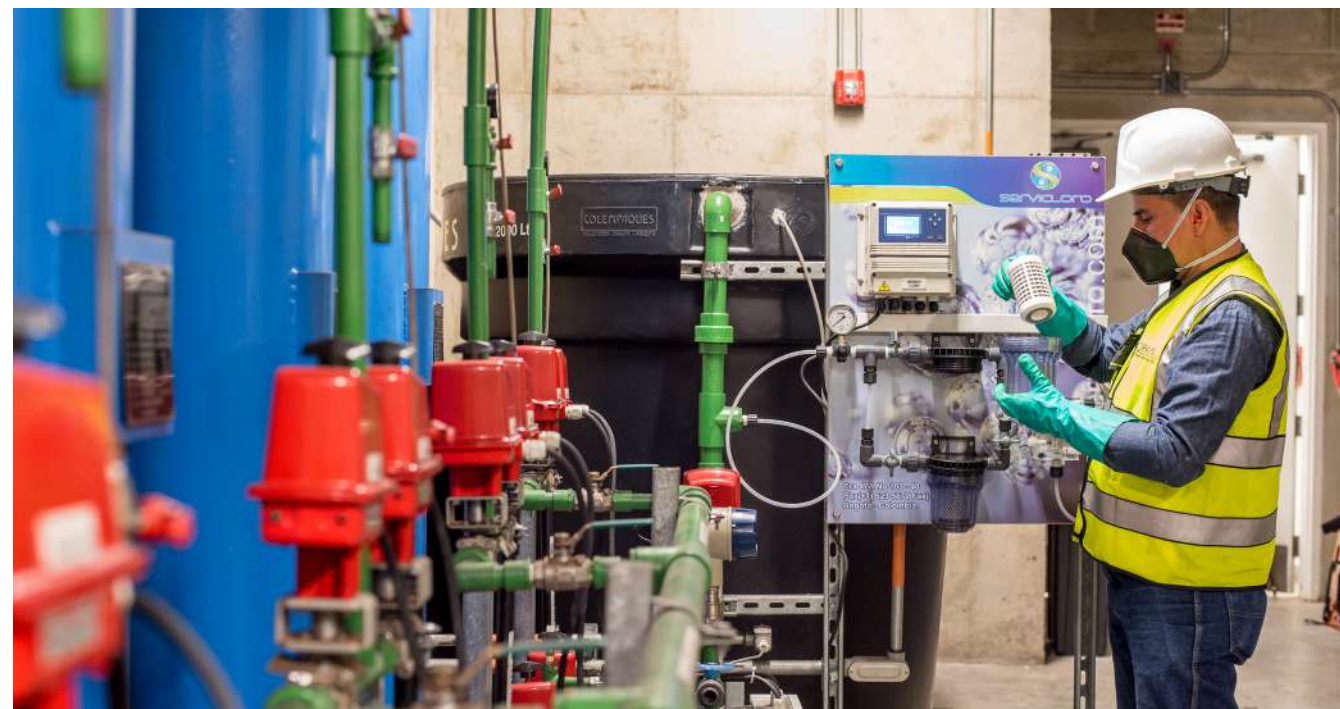
Wastewater treatment plant, Aeropuerto El Dorado.
