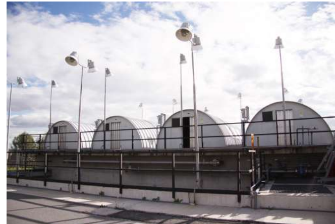
Wastewater treatment plant, Aeropuerto Mariscal Sucre.
